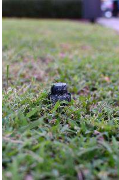
Imagen 23: Sistema de riego
